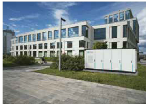
规模: 500kW/1075kWh 项目: 中山市·某制造企业储能项目
