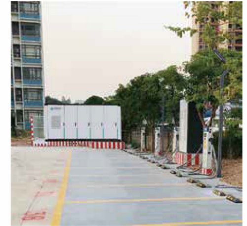
项目: 500kW/1075kWh 规模: 深圳市·某充电桩储能项目
