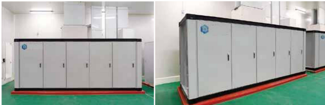
规模: 2500kW/5375kWh 项目: 东莞市·某科技公司储能项目
