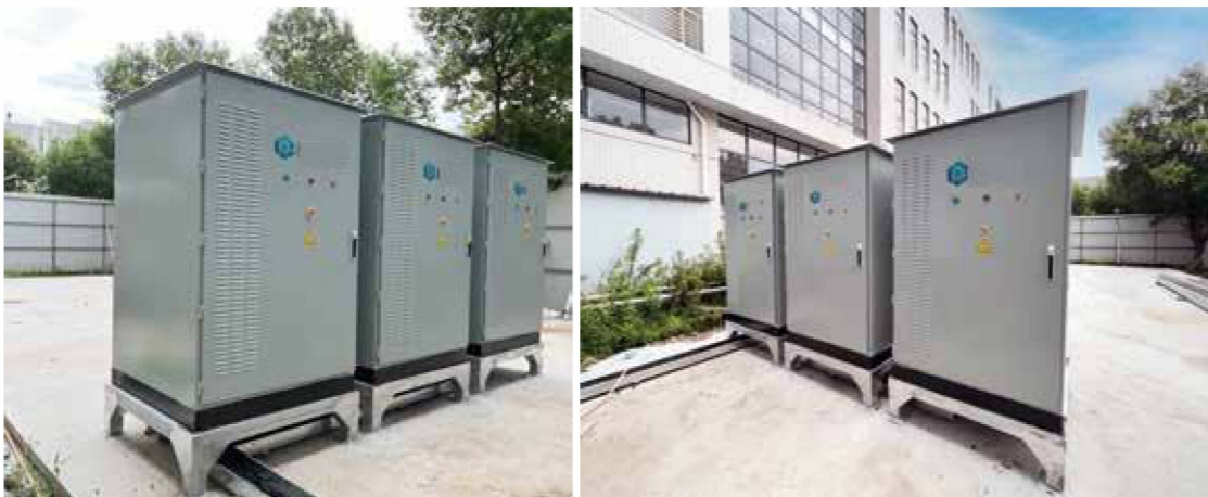
规模: 300kW/645kWh 项目: 上海市·某能源技术公司储能项目
