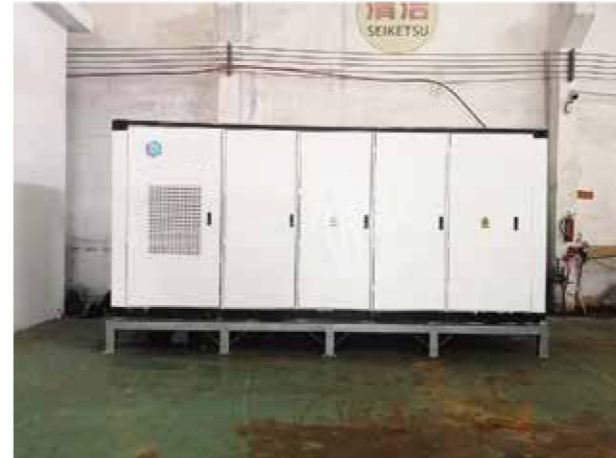
规模: 320kW/860kWh 项目: 广州市·某玻璃厂储能项目
