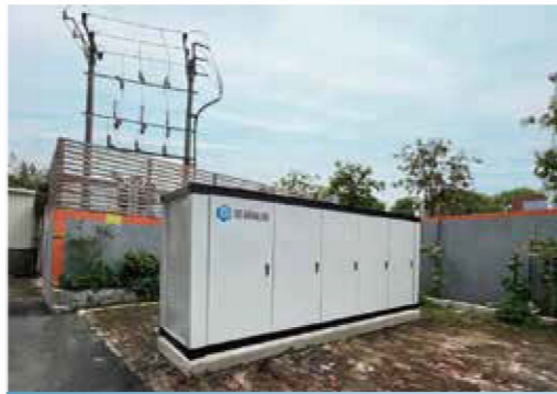
规模: 1000kW/2150kWh 项目: 东莞市·某医疗企业储能项目
