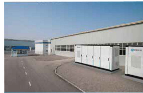
规模: 1500kW/3225kWh 项目: 佛山市·某制造企业储能项目
