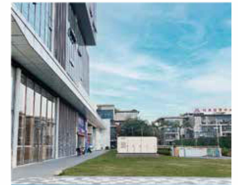
规模: 500kW/1075kWh 项目: 无锡市·某科技公司储能项目
