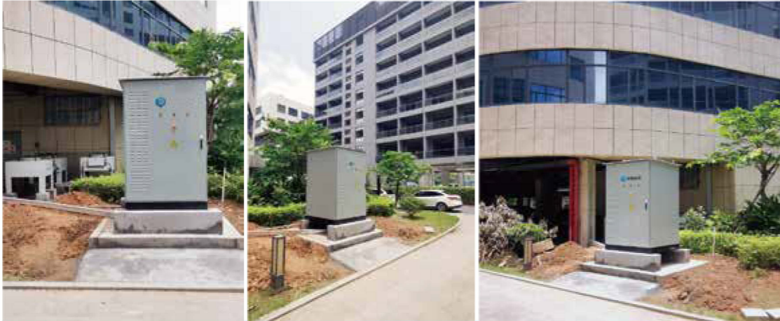
规模: 100kW/215kWh 项目: 珠海市·某园区储能项目
