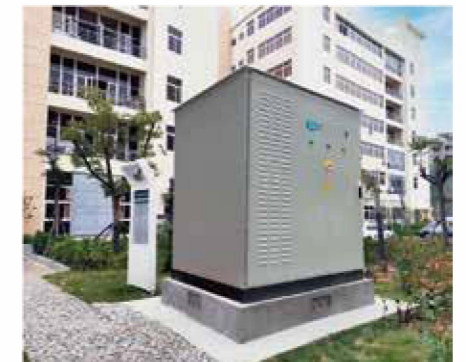
规模: 100kW/215kWh 项目: 佛山市·某创意园储能项目
