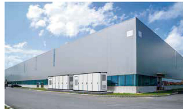
规模: 2000kW/4300kWh 项目: 九江市·某制造企业储能项目
