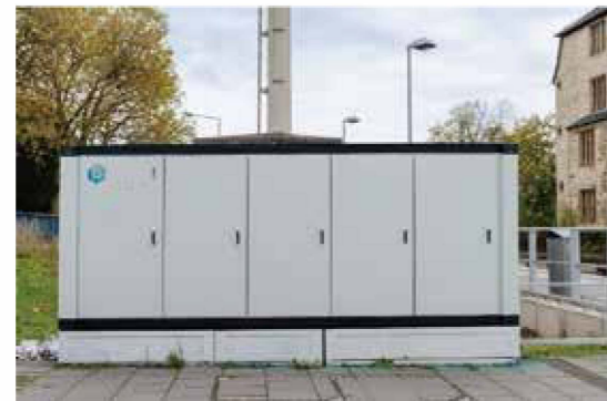
规模: 500kW/1075kWh 项目: 苏州市·某制造企业储能项目
